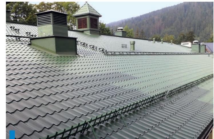
Doradcy energetyczni NFOŚiGW konsultują m.in. projekty termomodernizacyjne. Na zdjęciu siedziba – PSP w Zakopanem
